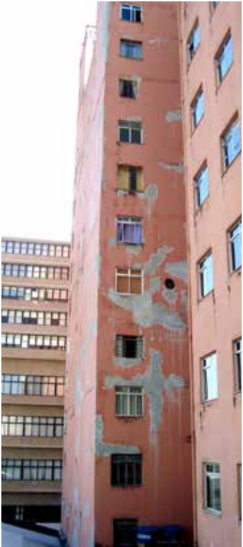
Exemplo de patologia sem a manutenção preventiva.
