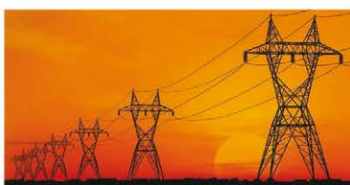
INSTALAÇÕES ELÉTRICAS EM MÉDIA E ALTA TENSÕES
