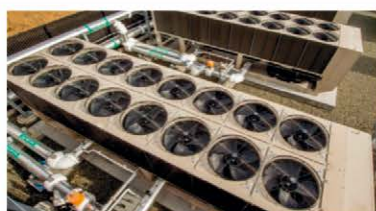
SISTEMAS DE CLIMATIZAÇÃO
