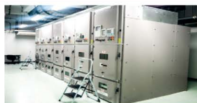
SUBESTAÇÕES DE ENERGIA
