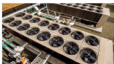
SISTEMAS DE CLIMATIZAÇÃO
