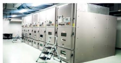
SUBESTAÇÕES DE ENERGIA
