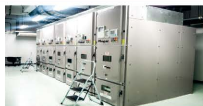
SUBESTAÇÕES DE ENERGIA
