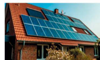
ENERGIA SOLAR FOTOVOLTAICA
