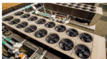
SISTEMAS DE CLIMATIZAÇÃO
