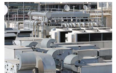
SISTEMAS DE CLIMATIZAÇÃO
