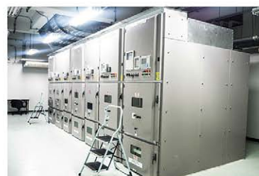
SUBESTAÇÕES DE ENERGIA ABRIGADAS PADRÕES LIGHT E ENEL
