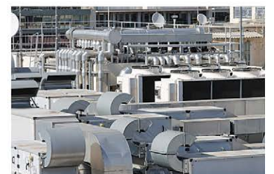
SISTEMAS DE CLIMATIZAÇÃO
