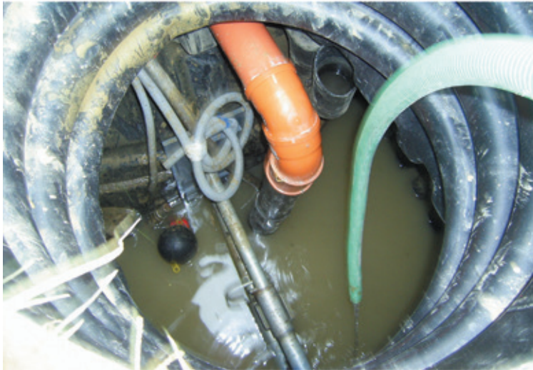
■ Para não chegar a ter o sistema de esgoto entupido é necessário fazer limpezas periódicas.
