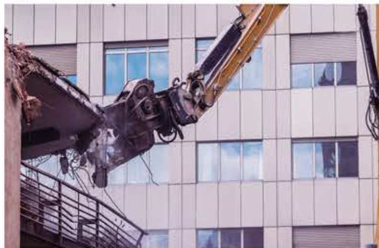
■ Nos condomínios, o vazamento hidráulico pode ser um problema silencioso e grave
